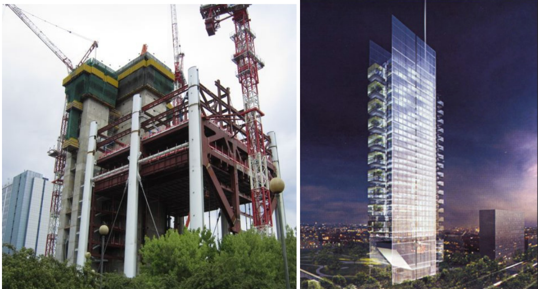
Figura 1-2 –Torre Intesa San Paolo, Torino, Italia, (2010/in costruzione). Altezza: 218 m; classe di resistenza: C70/85
